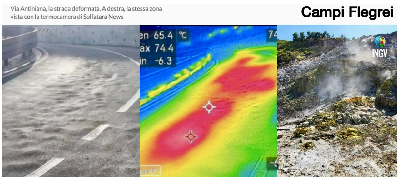
Obr. 62: Topenie asfaltu a unikajúce plyny. Zdroje:
